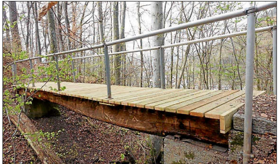
Eine 150 Jahre alte Eiche verschafft dem „Teufelsbrücke“ für die kommenden Jahrzehnte neuen Glanz und vor allem Stabilität und Trittsicherheit.
