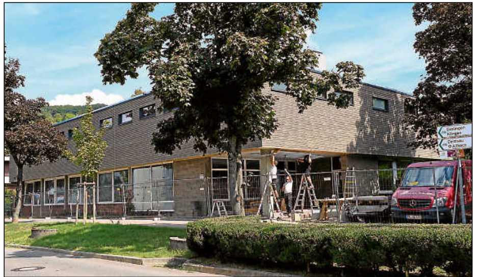
Die Turnhalle an der Esslinger Straße trägt ein neues Kleid aus Holz: Das Gerüst wurde kürzlich wieder abgebaut und die Arbeiten befinden sich in den letzten Zügen.
